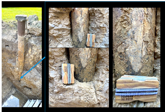
Joonis 3. Fotod puuduva tsementatsiooniga puurkaevust. Puurkaevu ning moreenpinnase vahele on jäänud puurpea tehtud tühemik, kus puudub tsementtäide. Sellise tühemiku kaudu pääseb pinnavesi ning maapinnal olev reostus puurkaevu töötavasse ossa.
